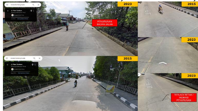
Gambar 4. Badan jalan mengalami penurunan sekitar 30 cm dari elevasi saat setelah dibangun sampai sekarang (10 tahun)
