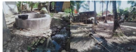
Gambar 8. Sistem utilitas air bersih dan air kotor tidak ada sehingga halaman rumah menjadi bau dan kotor serta tergenang ketika hujan turun.
