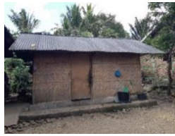
Gambar 11. Adanya hunian rumah yang tidak ada ventilasi untuk udara dan cahaya matahari
