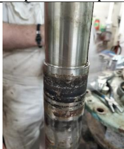
Shaft Pompa yang aus
